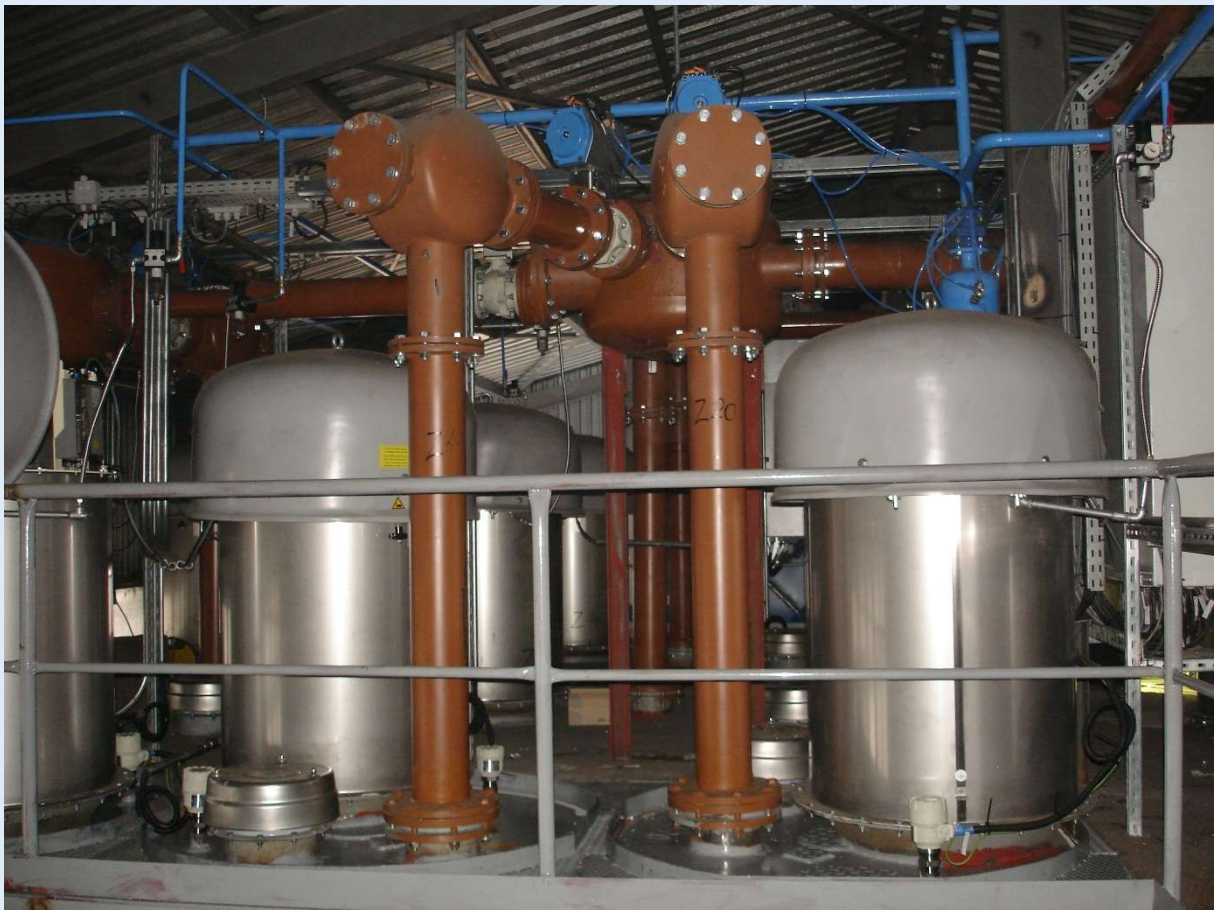
Beispiel: Verteilerstation 4-fach und Siloeinlaufstation (Spinelle)
