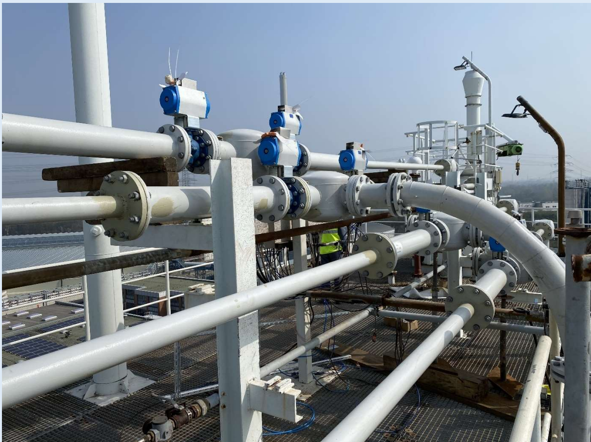
Beispiel: Verteilerstation (Bett- und Fluggas)
