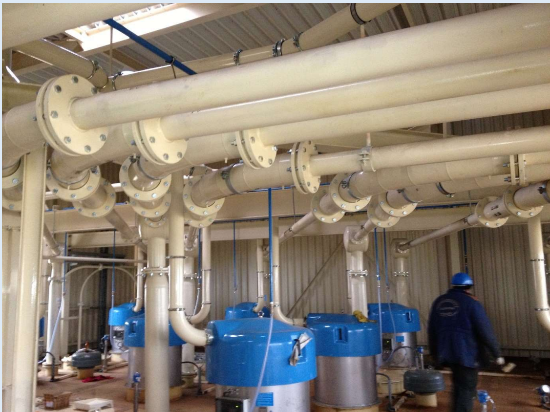
Beispiel: Förderrohrbögen mit Schmelzbasaltauskleidung
