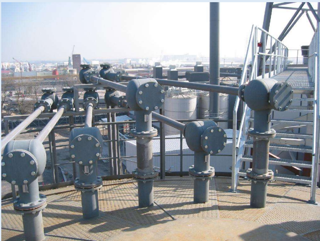
Beispiel: Umlenkstation und Siloeinlaufstation (Aschen)
